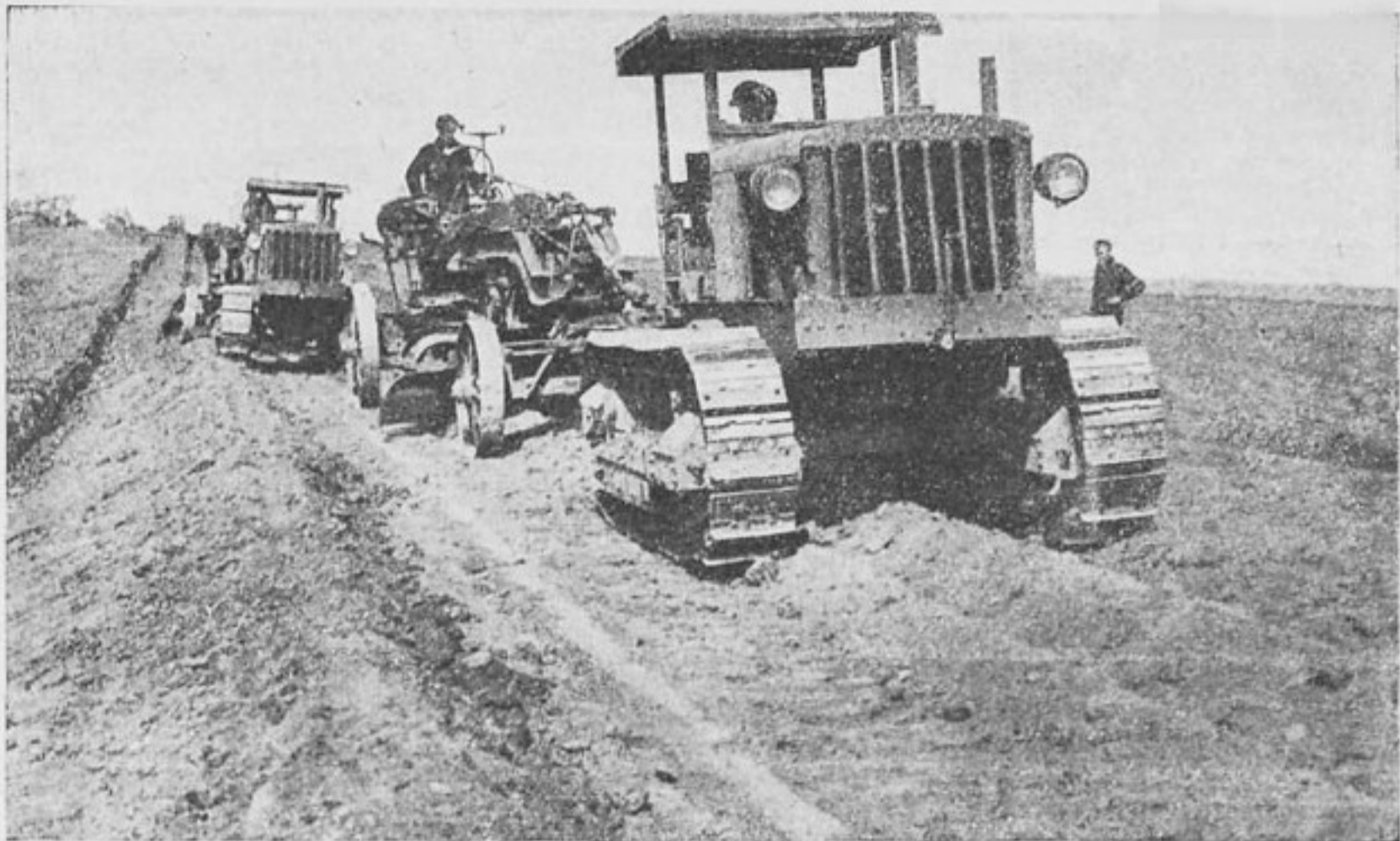
Трактора на дорожных работах. Прокладка шоссе машинами на участке Бобрики—Кашира—Москва, протяжением в 200 километров
